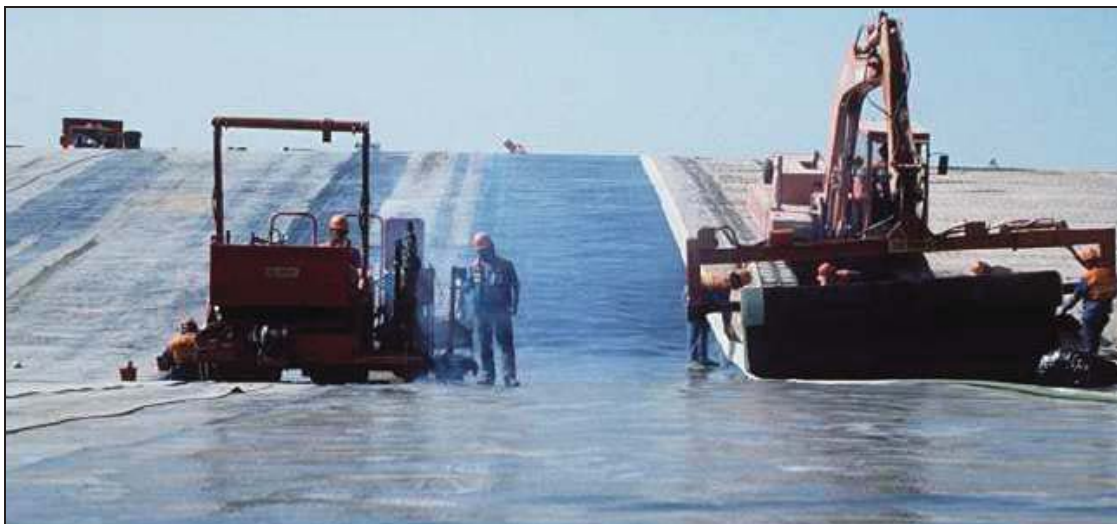
Figure III. 1.9 : Pose d'une bande de membrane bitumineuse en parallèle à son soudage (Source : centre de stockage des déchets radioactifs de la Manche, 1993)
