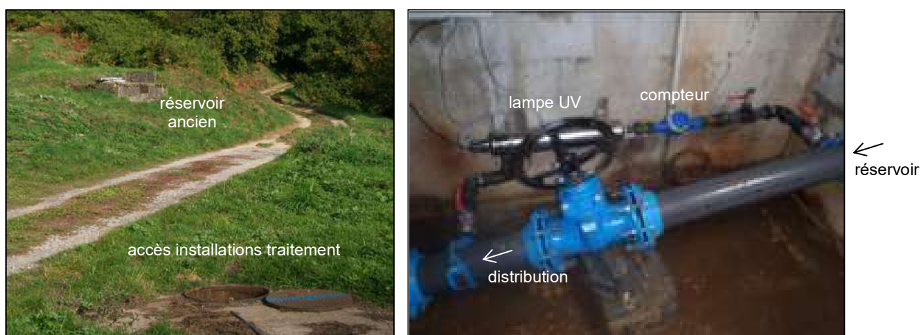
Les installations de traitement UV
