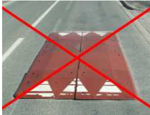
Coussin en caoutchouc qui présente une usure avancée et dont les parties sont disjointes entre elles. (Source : FFCT)
