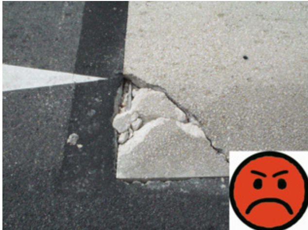
Exemple d'un bord de coussin en béton effrité. (Source : Kéolis-Lyon)
