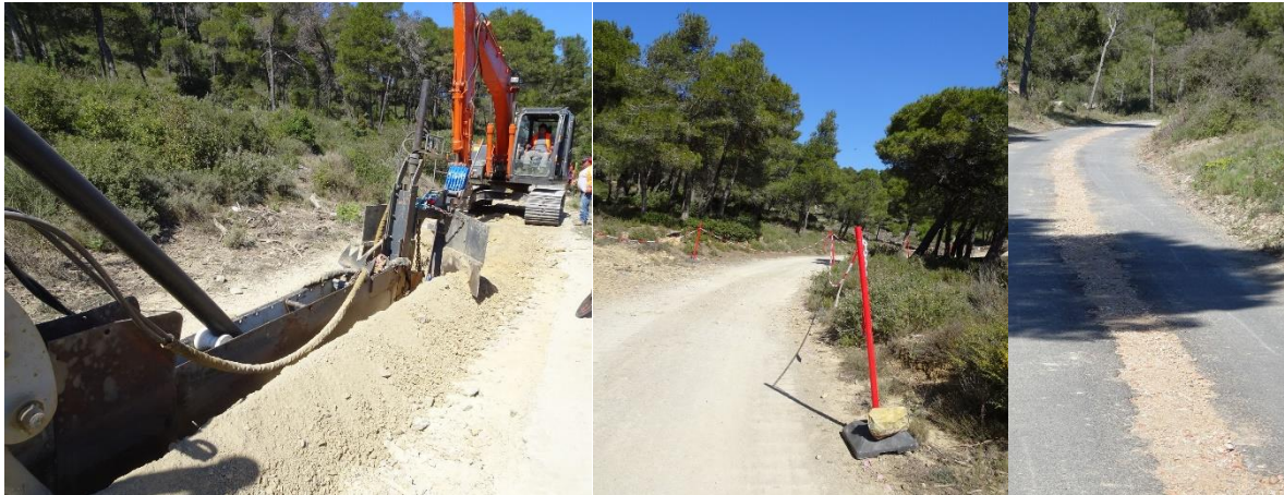
Trancheuse qui installe la canalisation à gauche, balisage des milieux naturels au centre et rendu une fois la canalisation installée au niveau d'une zone revêtue à droite – CBE, 2021
