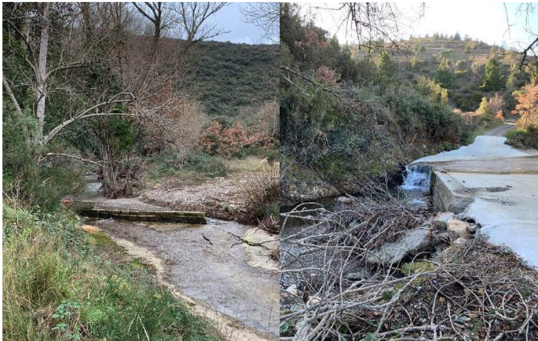
Figure 15. Photographie de la zone busée : entrée et sortie (de gauche à droite)
