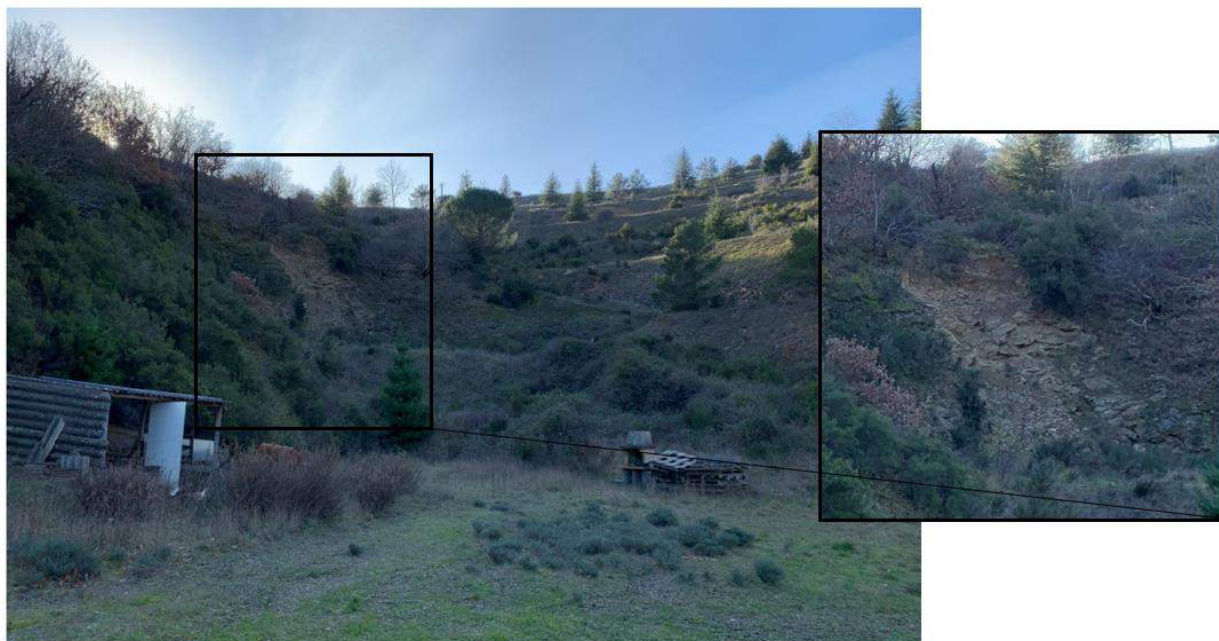
Figure 59. Glissement superficiel observé au droit de la galerie d'aérage Ramèle (Janvier 2020)
