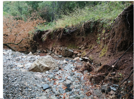
Erosion de la berge
