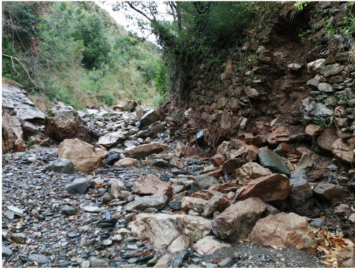
Effondrement du mur
