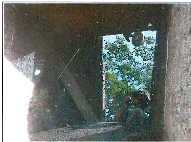
Captage de Source Ancienne Petite
