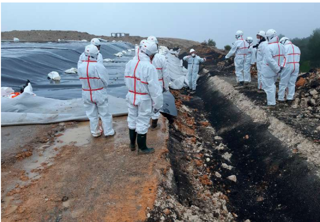
Travaux de réfection de l'étanchéité du stockage de résidus miniers de Montredon
