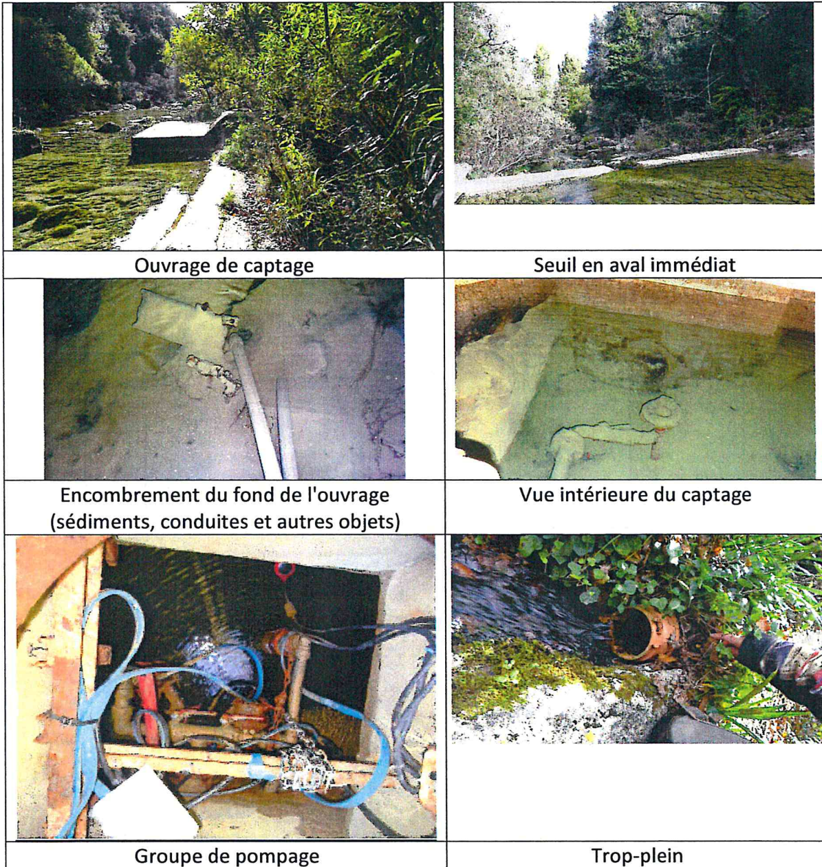
Figure 9 : planches photographiques du captage
