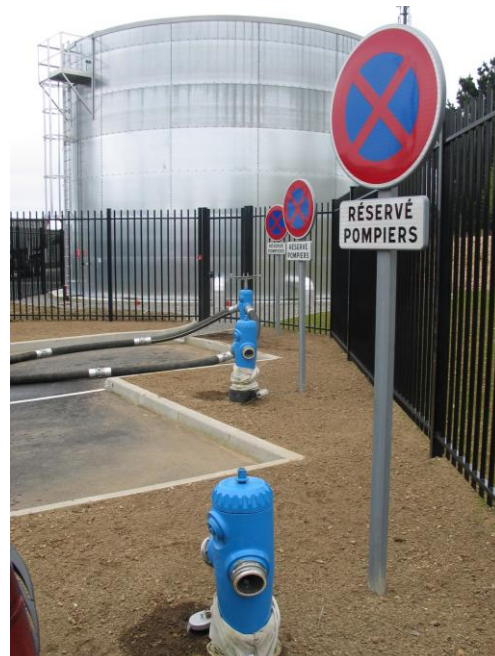
Réserve d'eau incendie aérienne de 720 m 3 équipée de 3 poteaux d'aspiration de 150 mm
