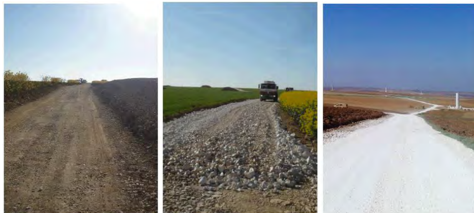
Opération de décapage ; mise en place de la couche de fond de forme ; mise en place de la couche de finition Photos de gauche à droite. Source EOLE-RES – Parc éolien de La Forterre (89).
