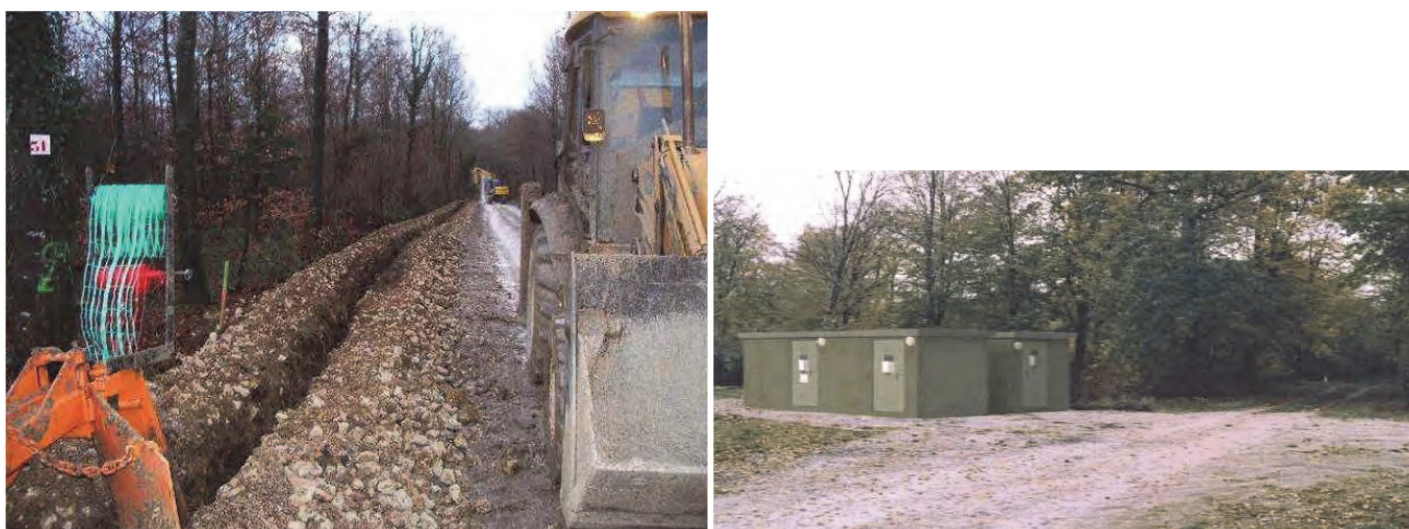
Opérations d'enfouissement des réseaux (à gauche) et Structures de livraison (à droite)
