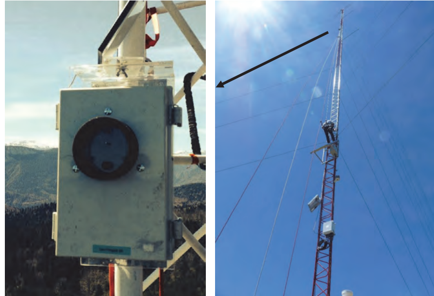
Photographie 52 : Batcorder® installé sur le mât de mesures anémométrique à 60m (source EXEN/KJM Conseil)
