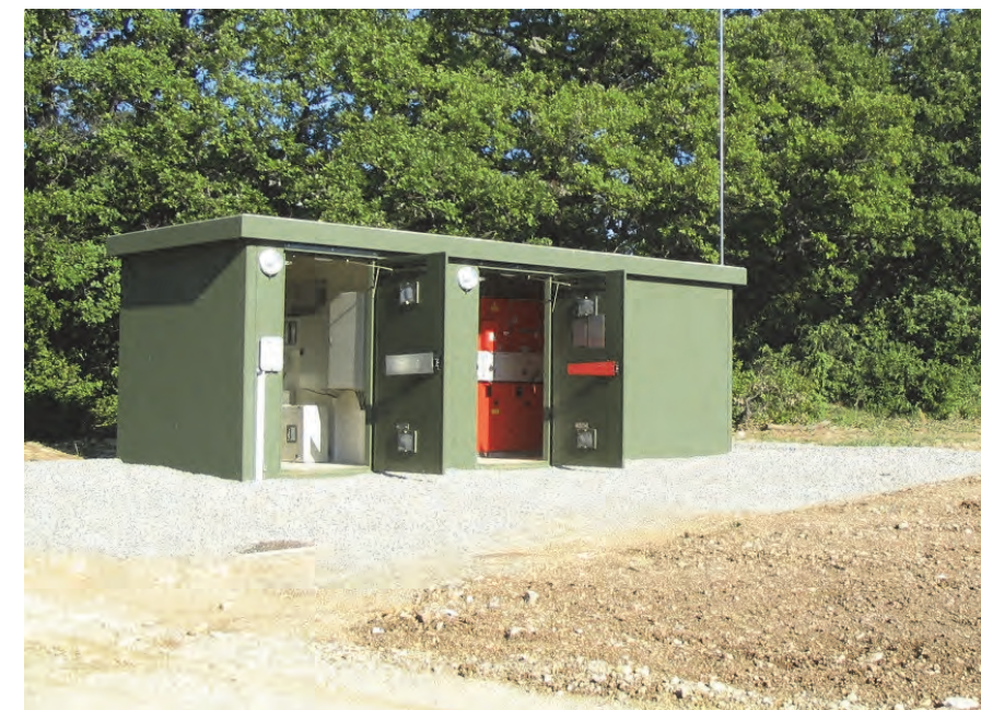
Photographie 2 : Exemple de poste de livraison
