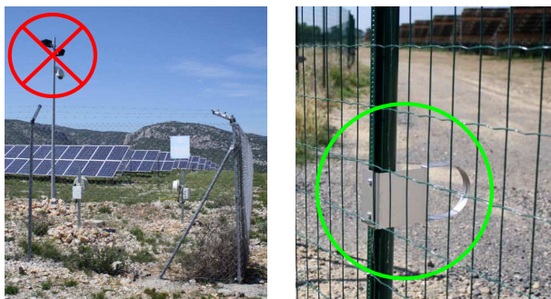
Exemple en vert de détecteur d'intrusion lié à la clôture Parc EDF-Energies Nouvelles - St-Marcel-d'Aude
