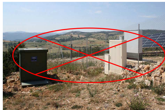
Contre exemple ; Juxtaposition de coffrets techniques en entrée de parc
