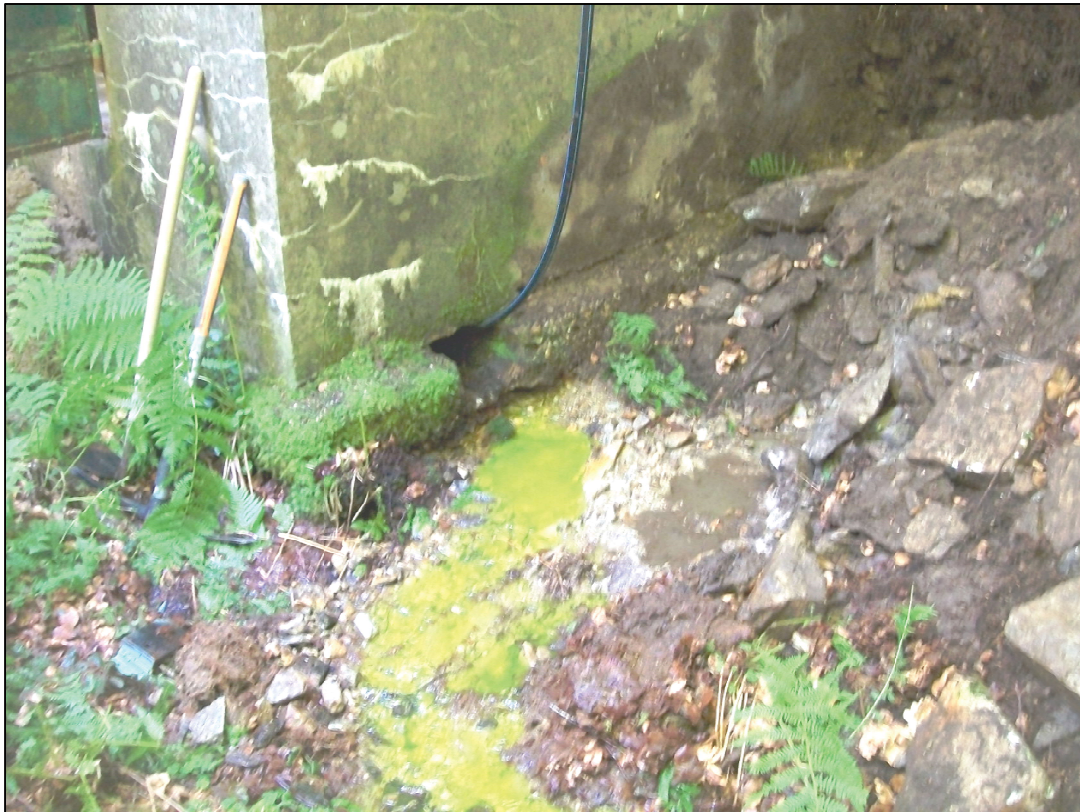
Apparition du colorant dans l'arrivée d'eau extérieur après injection du traceur dans les galeries drainantes à l'intérieur du captage
