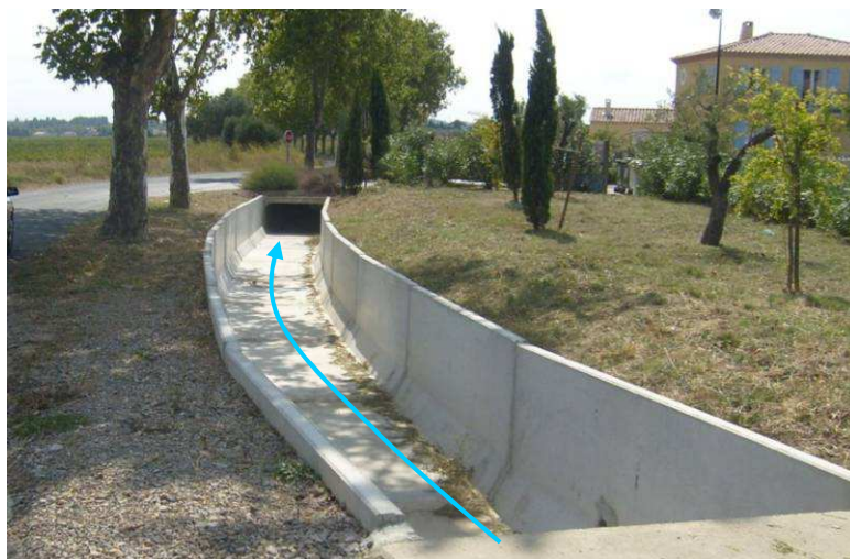
Figure 11 : Cuvelage du ruisseau de la Gravière
