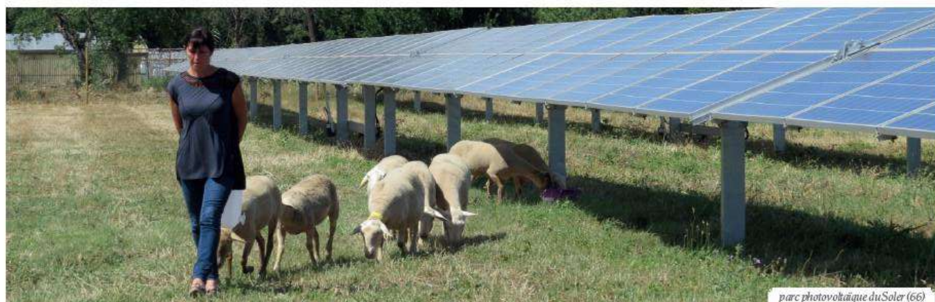
parc photovoltaïque du Soler (66)
