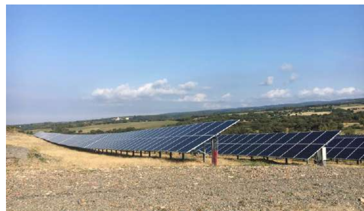
Figure 11: Modules positionnés sur une structure mono-pieux (source : BayWa r.e. France)
