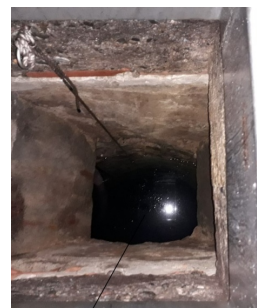
Niveau de l'eau 2 à 4 m : pompe fixe immergée
