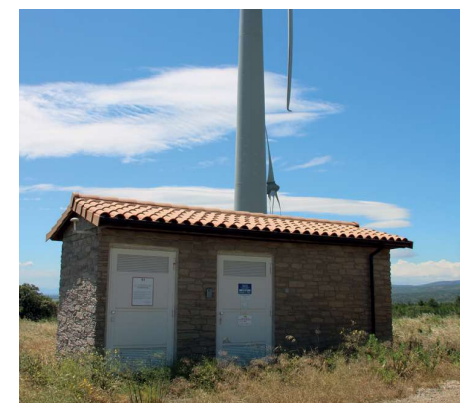
Privilégier des postes de livraison au langage sobre dans ses revêtements et en cohérence avec l'identité locale. Ici, les teintes des portes auraient dû être atténuées.
