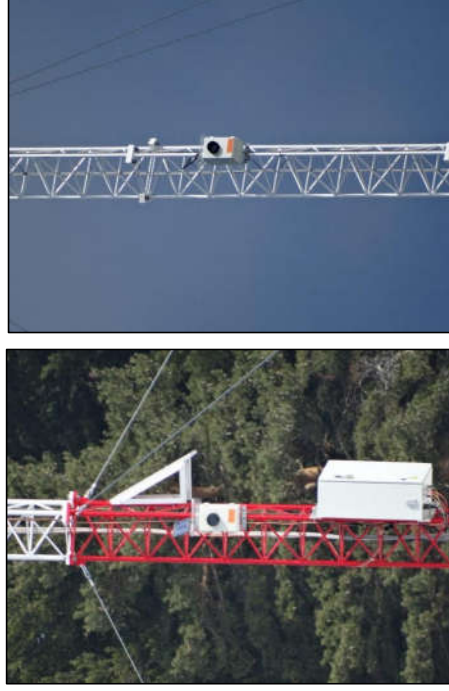
Figure 45 : Clichés du positionnement d'un module Batcorder autonome sur mât de mesure
