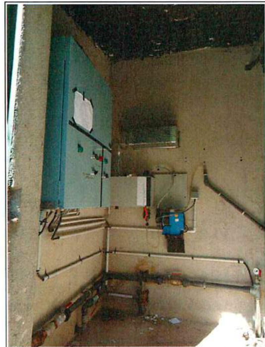
Unité de traitement au chlore liquide pour l'UDI n°3 de Gascou (Bugarach)
