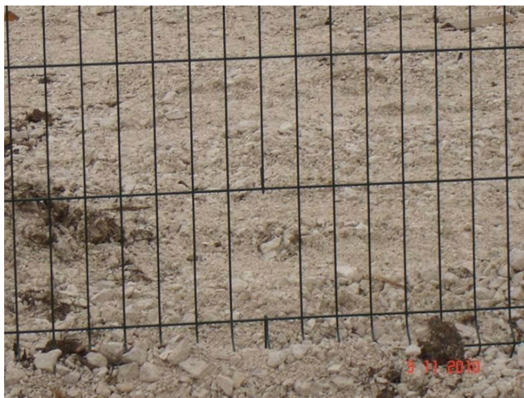
Exemple de dispositif passe-gibier mis en place
