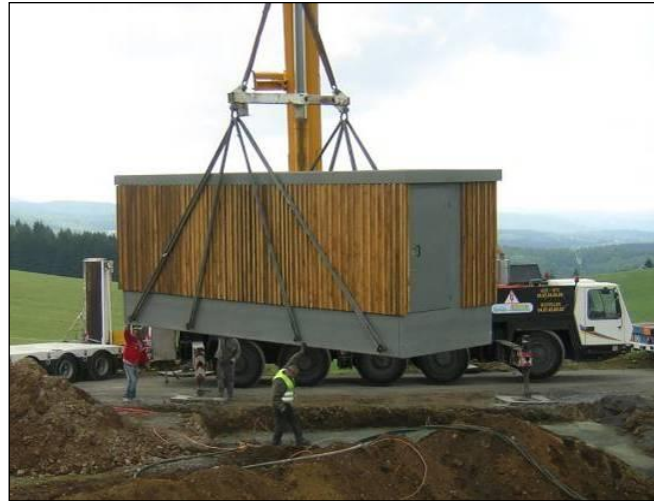
Exemple de livraison d'un poste de transformation électrique sur un parc éolien
