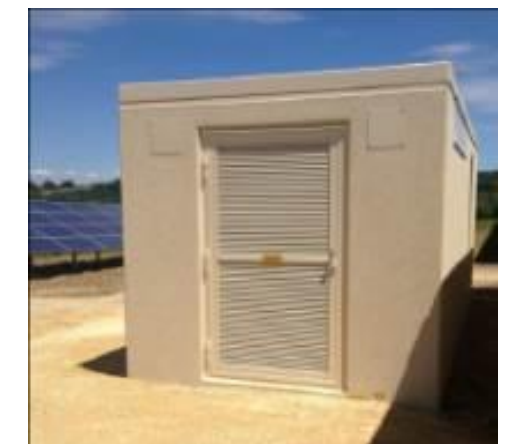
Figure 6 : Photo d'un poste électrique (Valeco)
