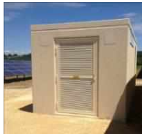
Figure 10 : Photo d'un poste électrique (Valeco)
