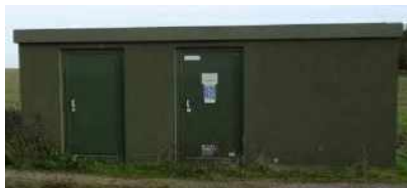
Illustration 26 : Exemple de postes de livraison et de transformation
