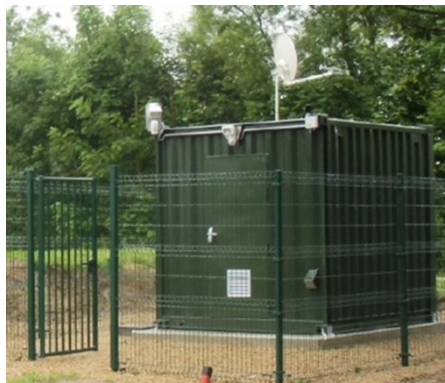
Photographie 4 : Exemple de poste de contrôle (Source : Arteria)
