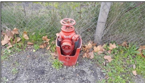
Photos du Poteau Incendie n°300
