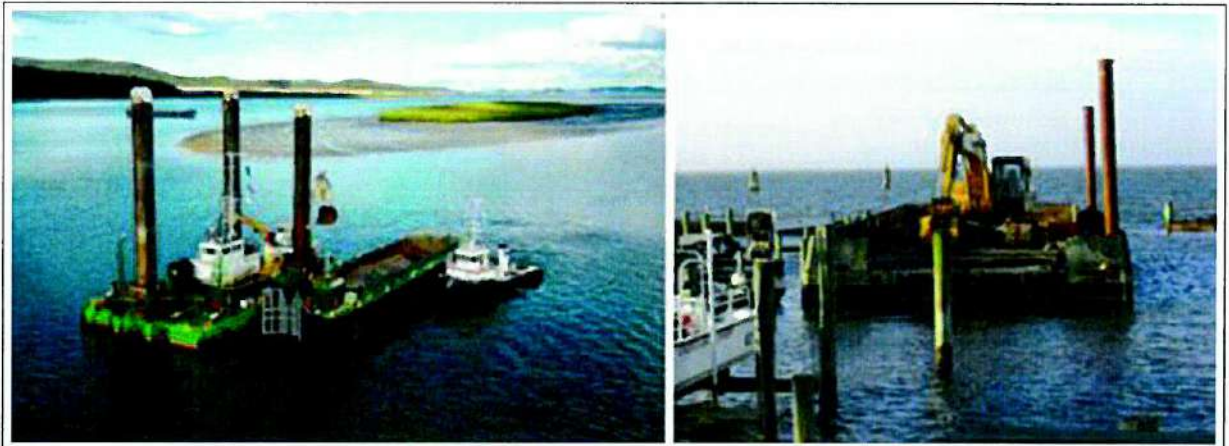
Figure 15 : A gauche : pelle rétro-caveuse, ici avec navire sablier et remorqueur ; à droite : pelle mécanique sur barge
