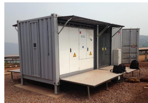
FIGURE 8 : PLATEFORME ONDULEUR – SOURCE : TOTAL SOLAR
