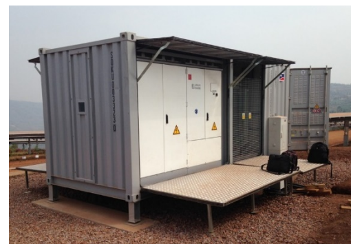
FIGURE 8 : PLATEFORME ONDULEUR – SOURCE : TOTAL SOLAR
