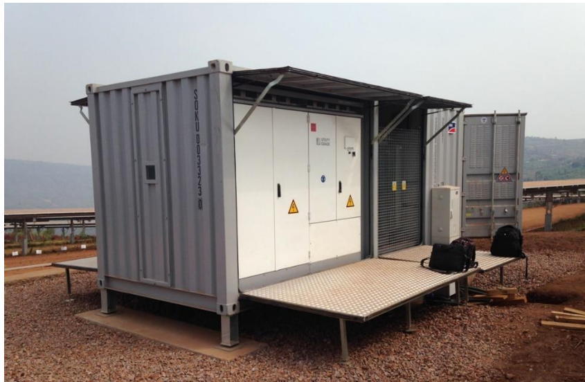
Photographie II-8 Exemple de plateforme onduleur (Source : Total Solar)
