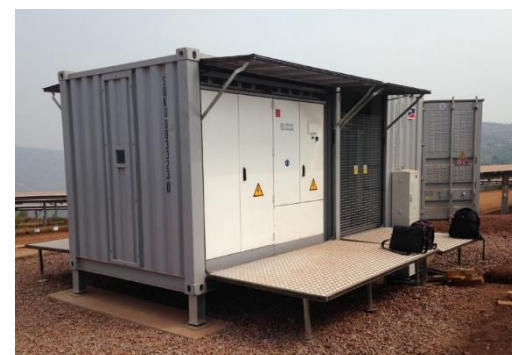
FIGURE 8 : PLATEFORME ONDULEUR – SOURCE : TOTAL SOLAR
