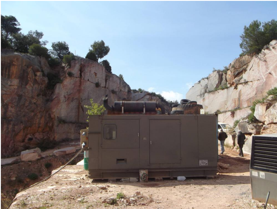
Groupe électrogène implanté au droit de la plate-forme technique 318 m NGF. Il assure l'alimentation de l'ensemble des outils de sciage et de découpe du marbre.
