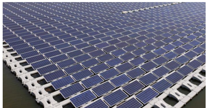
Assemblage de flotteurs avec panneaux solaires
