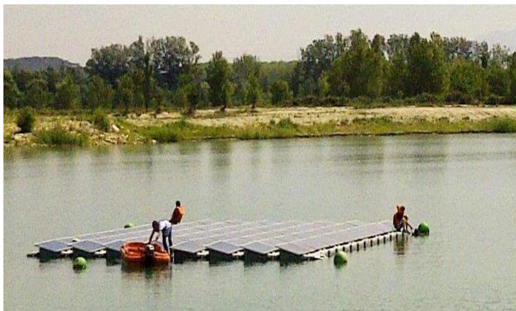
Illustration N° 5 : Photographie du prototype de structure photovoltaïque flottante, mis en place à Piolenc (Vaucluse) en juillet 2012
