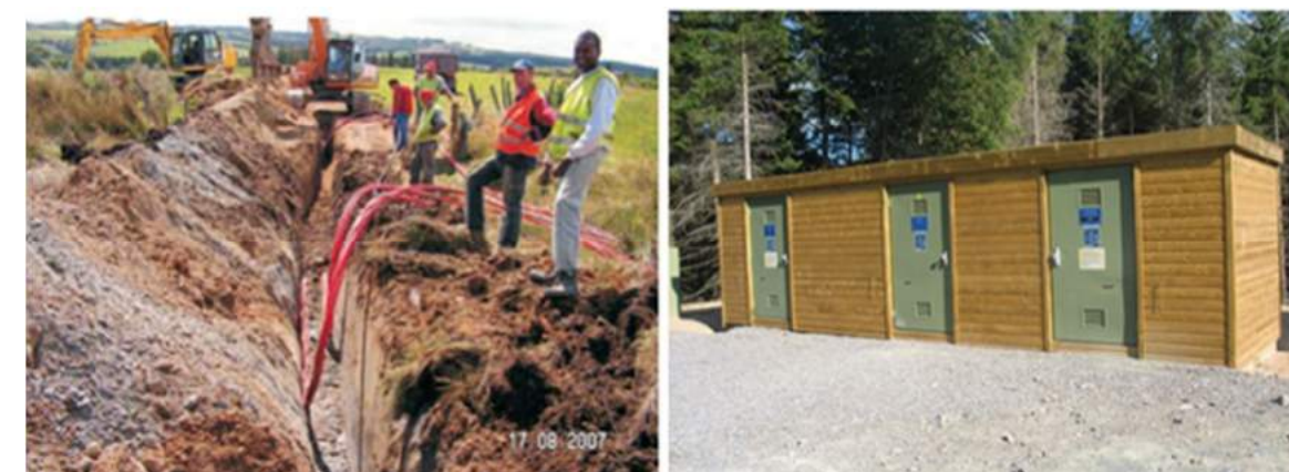
Figure 25 : Déroulage et pose des câbles (à gauche), poste de livraison (à droite) Source : EDF Energies Nouvelles
