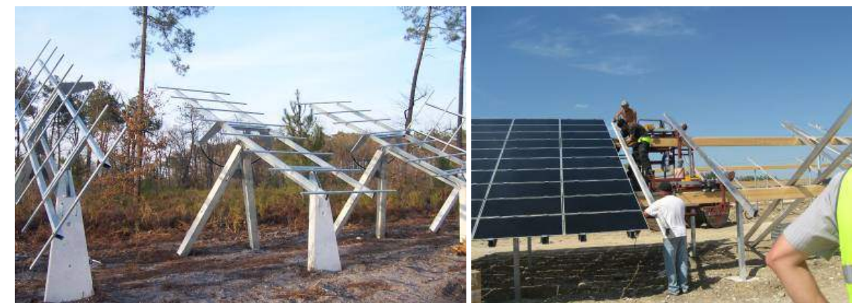
Figure 24 : Montage du support (à gauche), montage module (à droite) Source : EDF Energies Nouvelles
