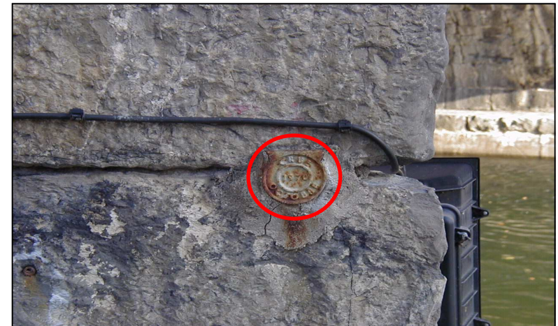
Selon les témoignages des riverains de la rue J. Baudru, la crue de 1970 aurait atteint au moins la hauteur de 0,50m dans cette rue. A vue d'œil l'implantation du repère de crue de 1970, est à une hauteur inférieure au niveau de la voirie actuelle. La crue de 1963 (repère non trouvé), est plus importante: son niveau dépasse de 1,59m celle de 1970. La zone inondable s'étendrait au-delà de ce qu'indique l'étude de Quillan.
