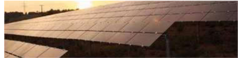
Vue proche des tables photovoltaïques – source First Solar
