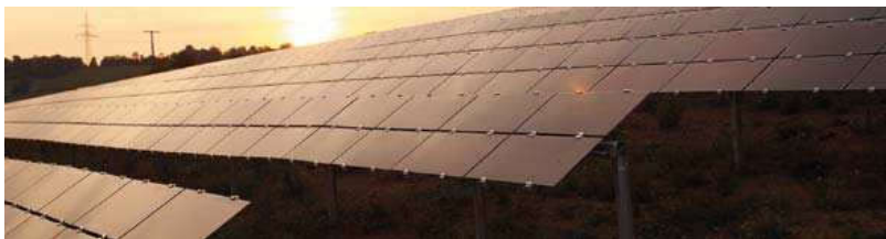
Illustration 12 : tables de modules photovoltaïques
