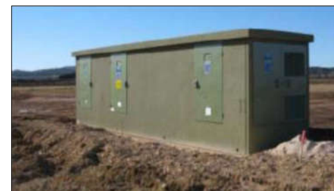
Illustration 14 : Exemple de poste de livraison de teinte vert-olive
