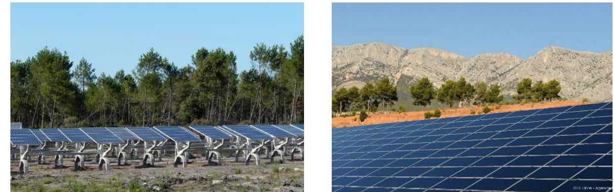
Figure 11 : Structures solaires (à gauche : les trackers de la centrale de Gabardan (40) qui suivent le soleil ; à droite : structures fixes à Puylobier (13)) - Source : EDF EN
