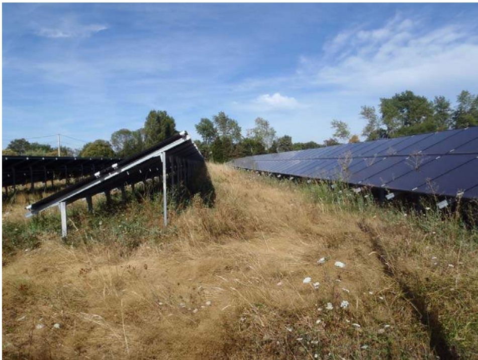
Centrale photovoltaïque existante et implantée sur la frange Ouest des terrains du projet (photo : SOE)
